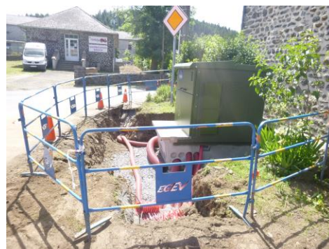
Rénovation du poste électrique, remplacement du H61 au de poteau par un PSSA 250KVA
