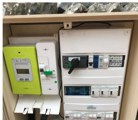
Armoire électrique montée par nos soins, alimentant l'éclairage public et la mise en valeur
